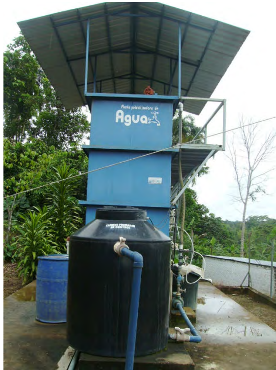
Sistema de Agua Potable Palma Roja
