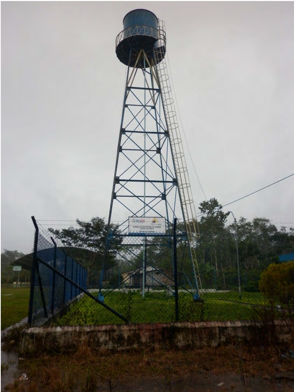
Tanque del SAP de Condor San Francisco
